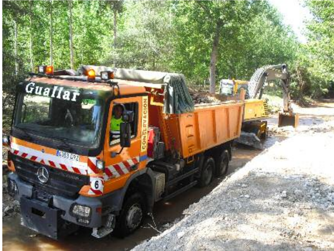
Trabajos llevados a cabo por Tragsa en el río Alfambra en la confluencia con el barranco del Cerezo en la mañana de ayer
